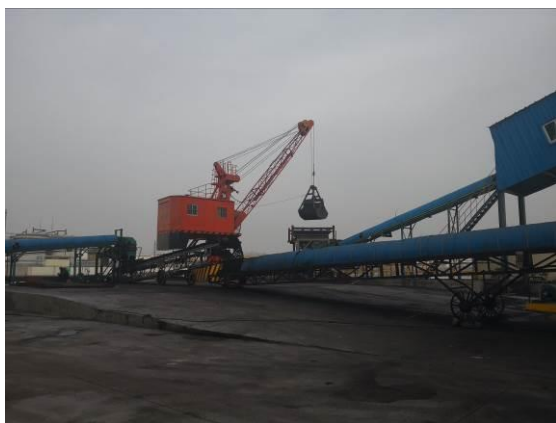
煤炭皮带输送线
